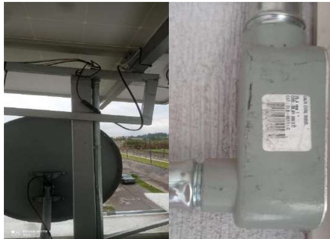
Figura 11. Conexiones: a) Bajada de cables y b) Caja oval ROCS. Fuente: elaboración propia.
